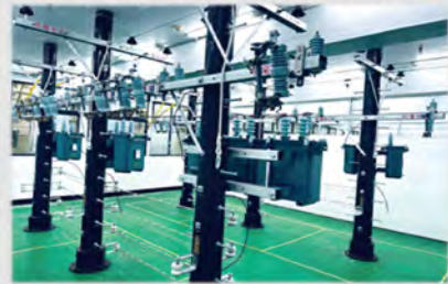
勞動部「室內配線乙、丙級」技術士考場
