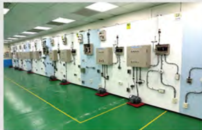
勞動部「室內配線乙、丙級」技術士考場
